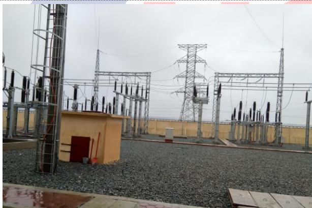
(Hình ảnh: Ngăn lộ mở rộng và đường dây 110kV Cẩm Hòa – Cẩm Xuyên, vận hành năm 2020)
