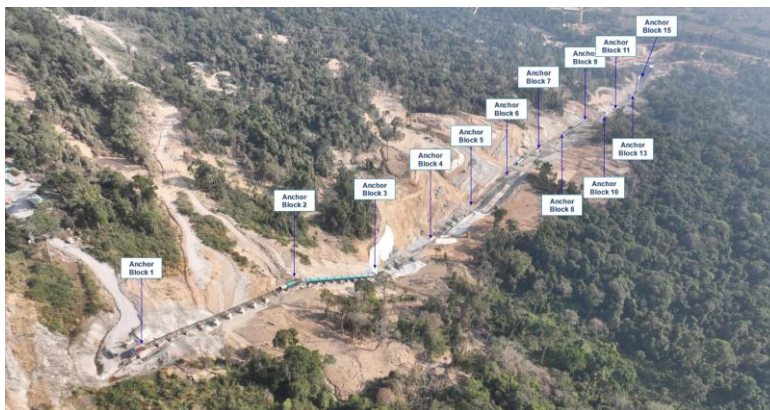
(Hình ảnh: Tuyến đường ống áp lực Nậm Phak, H_{max}=696m thời điểm tháng 02/2025)
