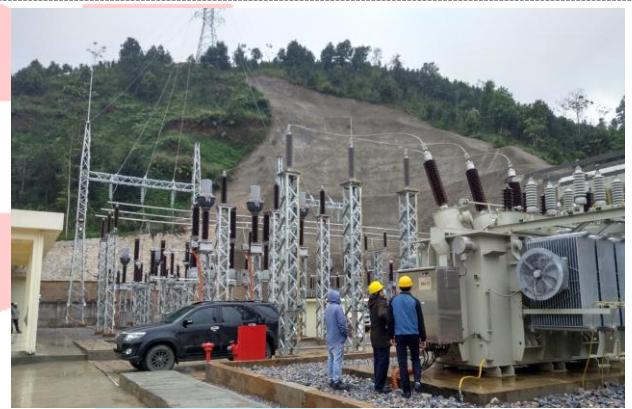
(Hình ảnh: Trạm gom và đường dây 110kV đấu nối thủy điện Bảo Nhai, vận hành năm 2022)
